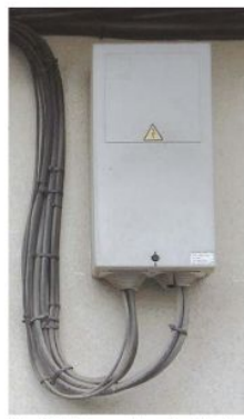
Figura 8.7. Caja general de protección de una acometida aérea.
