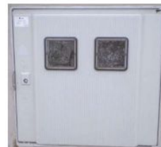
Figura 8.2. Caja de protección y medida (CPM).
