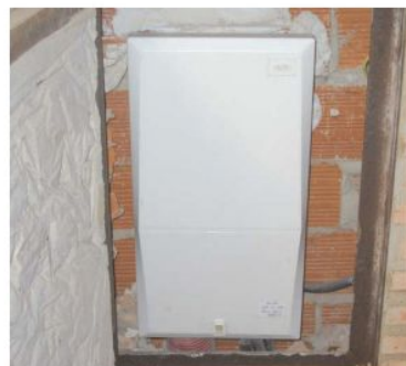
Figura 8.4. CGP alojada en nicho para una acometida subterránea con puerta revestida exteriormente con las características de la fachada.
