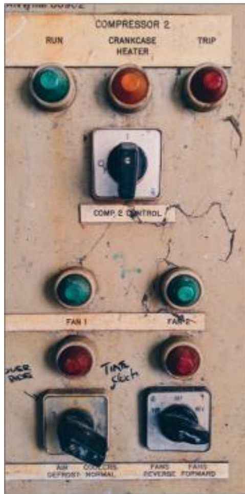
Figura 2.85 – Panel de control creado con cruzamientos, testigos e interruptores (foto de Nick Nice en Unsplash).
