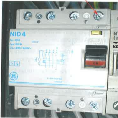
Figura 12.12. Dado que no existen diferencias tripolares, en líneas trifásicas sin neutro se conecta el conductor de protección en el borne de neutro solamente para que funcione el pulsador de test.
