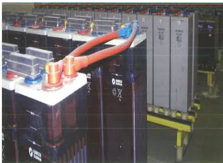
Figura 11.2. Sala de baterías de acumuladores para suministro complementario.
