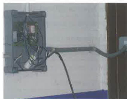
Figura 8.26. Cuadro de control de puerta de garaje.
