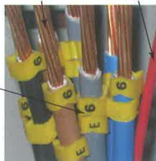
Conexiones en el contador
