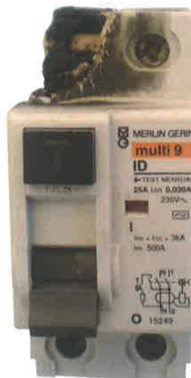
Figura 12.13. Diferencial quemado por falta de protección.
