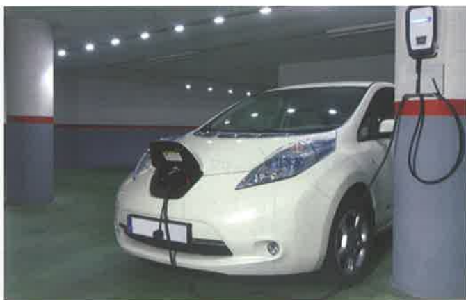
Figura 4.27. Equipo de recarga de vehículo eléctrico.
