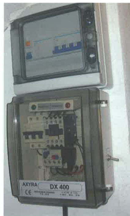
Figura 8.25. Cuadro de mando y protección de una bomba de elevación de aguas.
