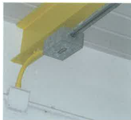
Figura 10.14. Canalización con pletinas conductoras.
