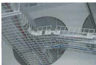
Figura 5.1. Canalizaciones al aire (en bandeja).
