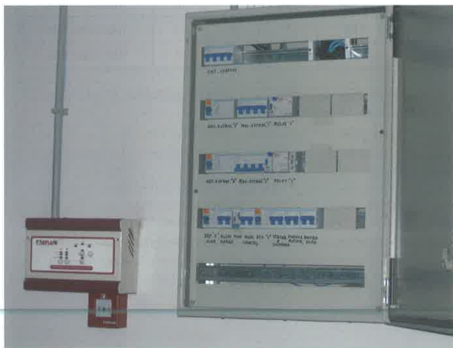
Figura 8.27. Armario de protecciones y control y central contraincendios de un garaje.
