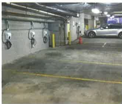
Figura 8.3. Estaciones de recarga de vehículos en garaje.
