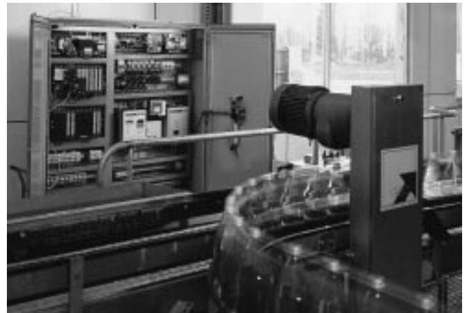
Línea de embotellamiento controlada por un autómatas TSX 7
