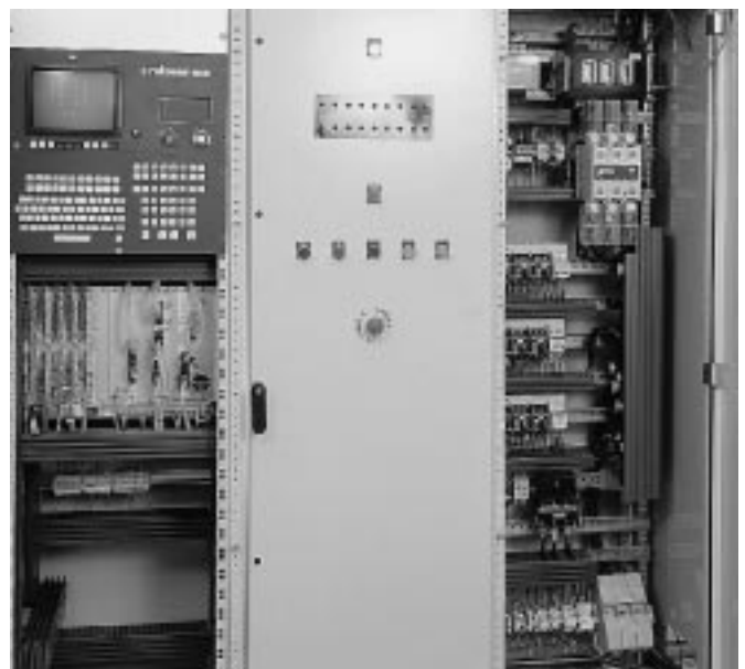
Control numérico NUM y arrancador en un armario
