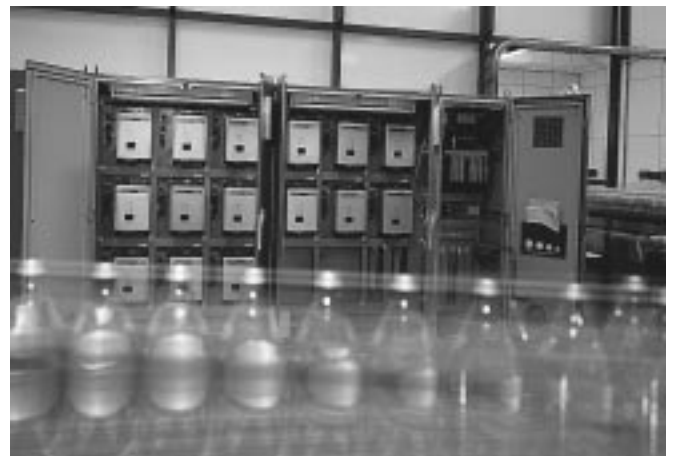
Cadena de embotellado controlada con variadores de velocidad Altivar
