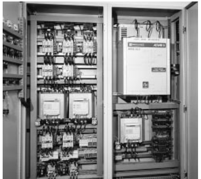
Arrancadores ralentizadores y variador
